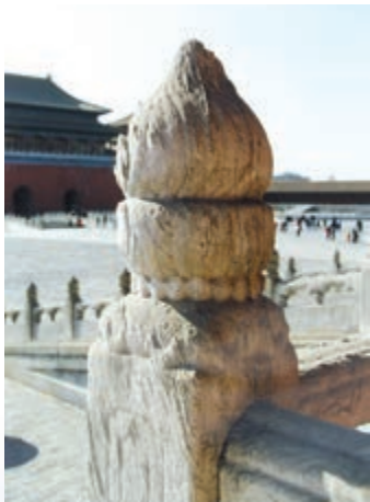
图22.4-3 被酸雨严重腐蚀的汉白玉石柱
