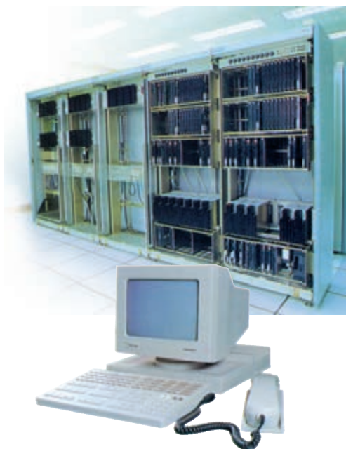
图21.1-6 程控电话交换机和操作台
